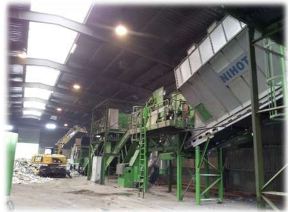
Ryc. 5 Fragment linii technologicznej instalacji do produkcji paliwa alternatywnego RDF.
