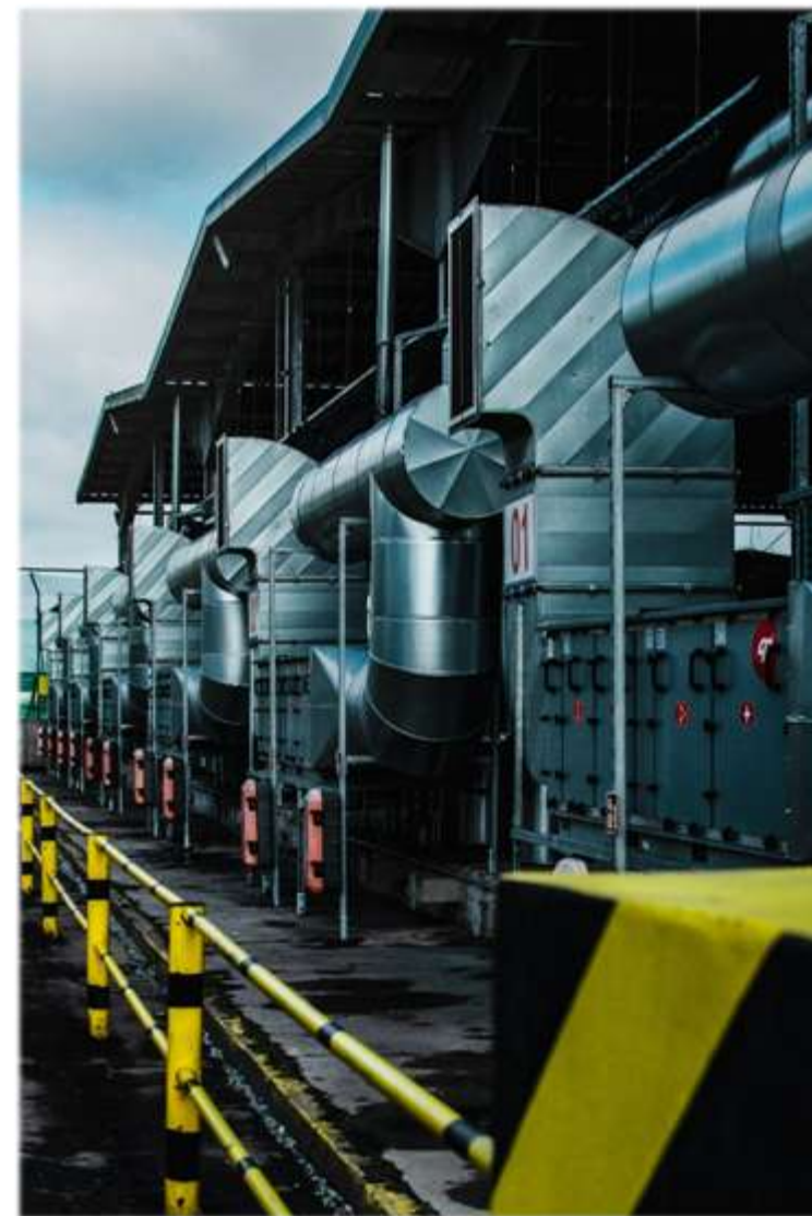
Ryc. 4 Centrale nawiewne do prowadzenia procesu biologicznego przetwarzania frakcji podsitowej.
